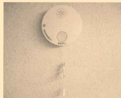
【火災警報器参考写真】
